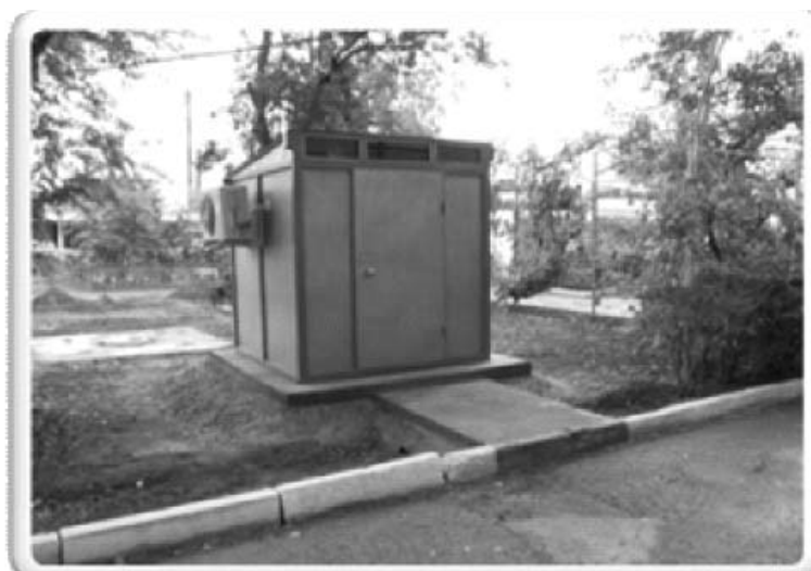
Рис. 2.1.9. Пост мониторинга РМ в г. Нукусе
